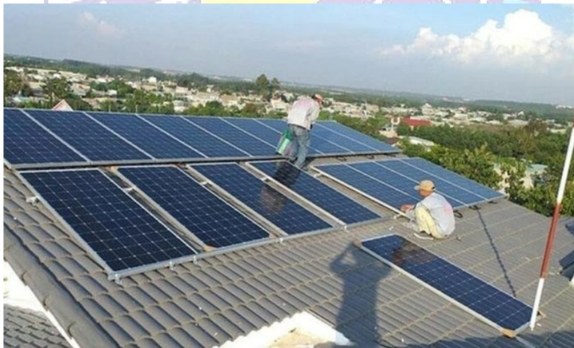
Người dân lắp đặt hệ thống điện mặt trời mái nhà. Ảnh: VGP
